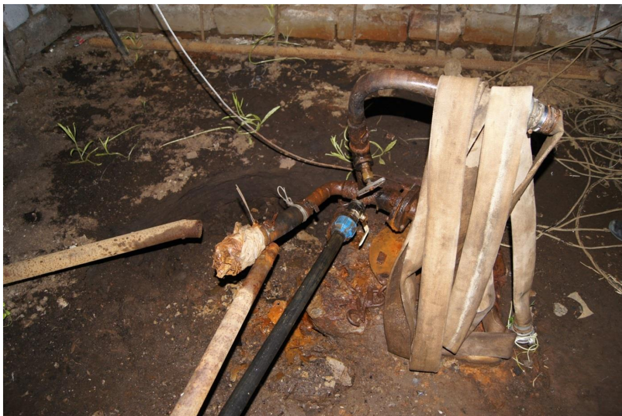
Рисунок 2.2 – Подземная камера скважины № 6 системы централизованного водоснабжения с. Кайлы
