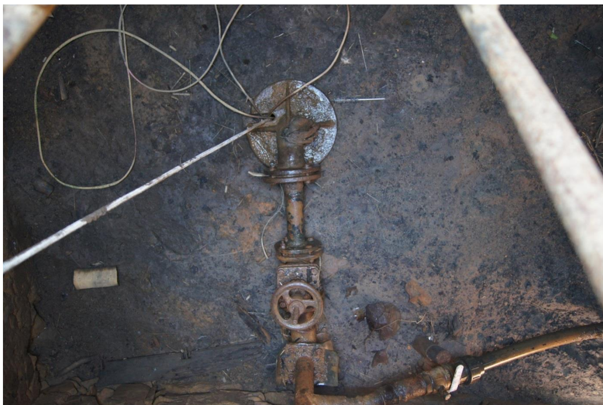
Рисунок 2.3 – Подземная камера скважины № 1 системы централизованного водоснабжения с. Кайлы
