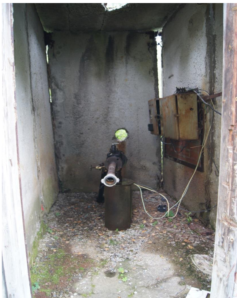
Рисунок 2.3 – Павильон скважины № 10-858 системы централизованного водоснабжения с. Томилово
