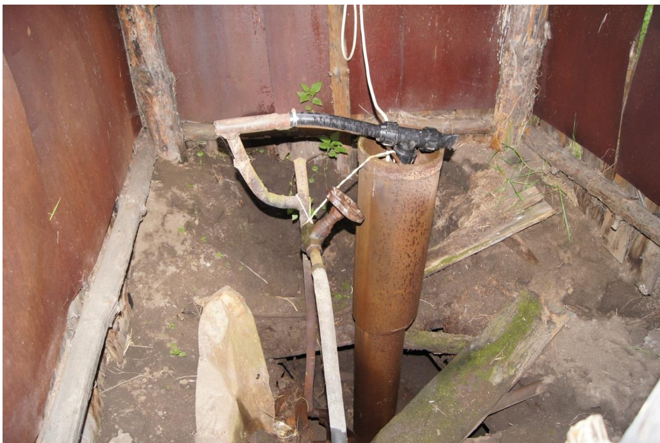
Рисунок 2.4 – Павильон скважины № 11354 системы централизованного водоснабжения с. Томилово
