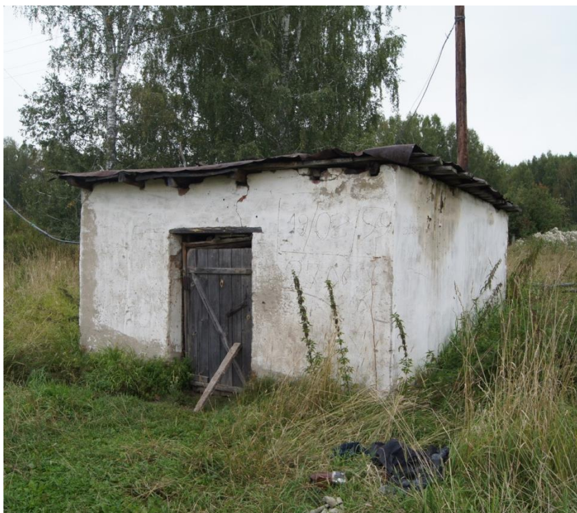
Рисунок 2.2 – Павильон скважины № 14 системы централизованного водоснабжения с. Томилово
